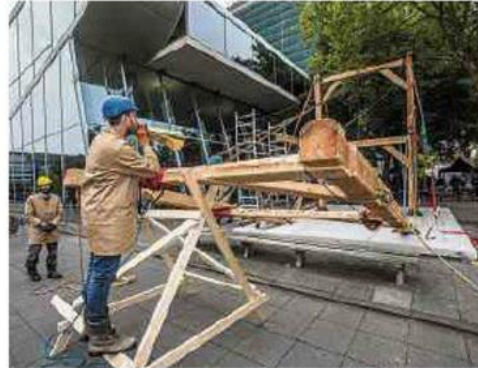
Met vereende krachten worden de spanten van het paviljoen omhoog gehesen. FOTO RIAS IMMINK
